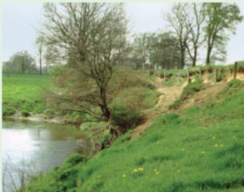
Abbruchkanten an der Berkel HG
